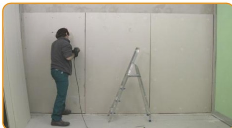
Fissare la seconda lastra di cartongesso al centro e ai lati con le apposite viti, sfalsando le lastre rispetto a quelle sotto
