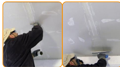
Applicare il nastro in rete nelle giunzioni delle lastre. Stuccare le giunzioni
